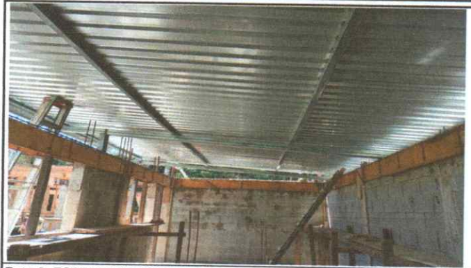
Foto 2: ESTRUCTURA SOPORTE DE METAL.
